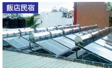
高雄 / 歐閣經典汽車旅館 2013年安裝，使用13年， NSK-45×48台
